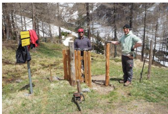
Wegebauprofis Christoph u. Johannes im Einsatz 7
